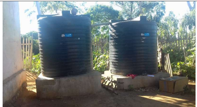
Les deux citernes de 2500 l installes aux niveaux de CSB
